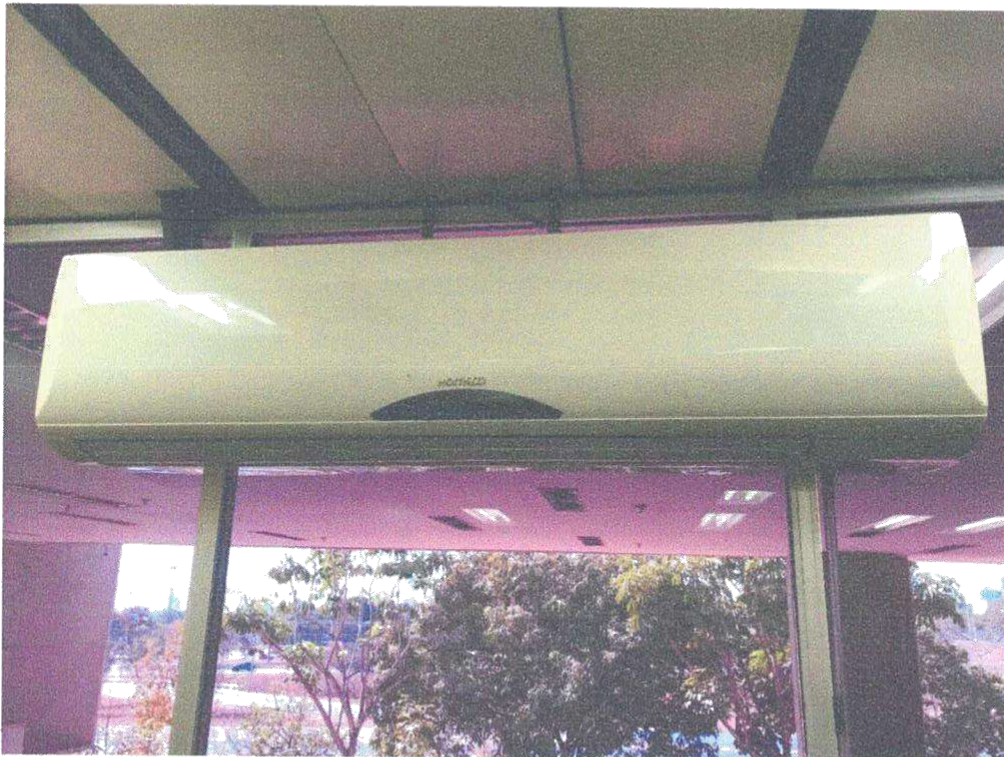
Especificação: Aparelho de ar-condicionado – Marca: Komeco – N° de Série:JAA0GBC2085080002445
